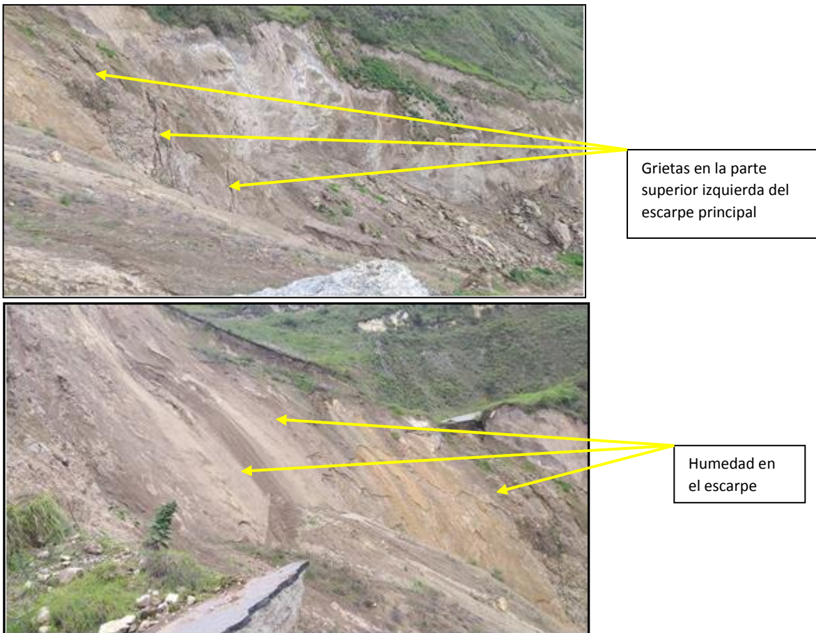
Imagen 5 y 6: Imágenes en la parte alta del escarpe principal.
