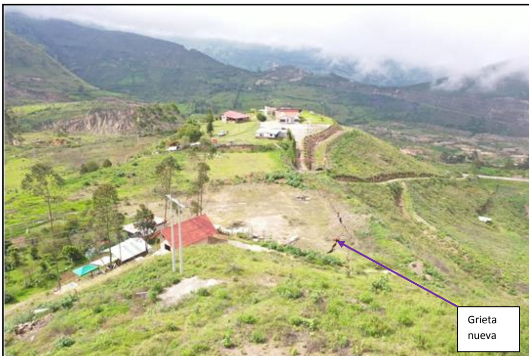
Imagen 3: Grietas sobre el sector de la gallería.
