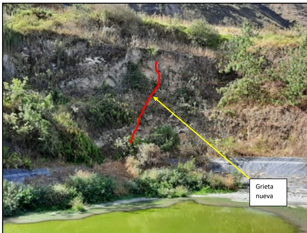
Imagen 1: Grietas sobre la piscina de oxidación.
