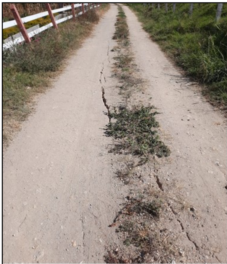
Imagen 2: Grietas sobre la vía en la parte baja piscina de oxidación.
