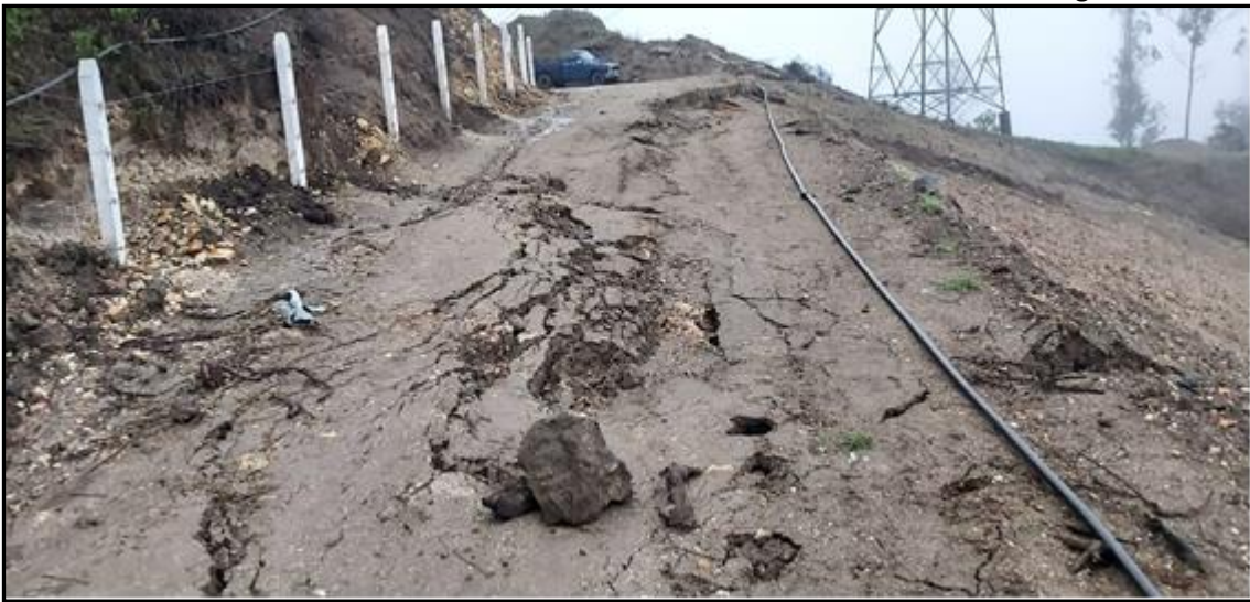
Imágenes 5 y 6: Afectaciones a la vía de tercer orden en la parte alta del deslizamiento.
