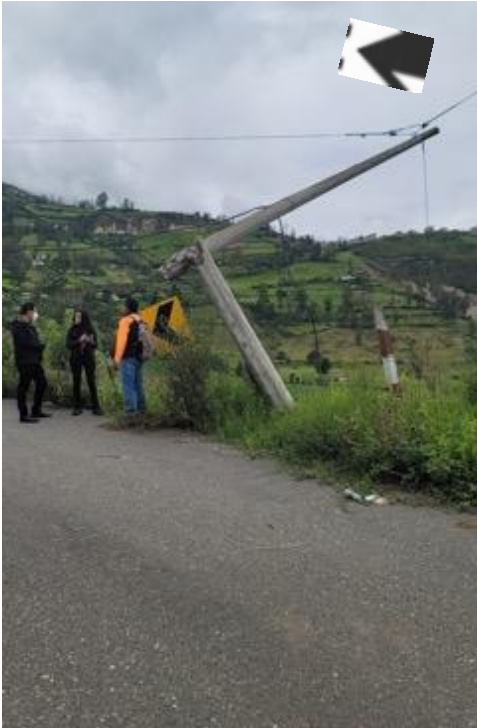
Imagen 5: Basculamiento del terreno en la vía La Armenia - Chunchi (729946, 9747508)
