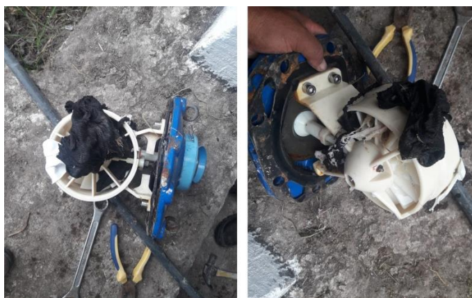
Fotografía 73 Revisión de macro medidor obstruido
