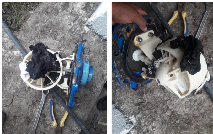
Fotografía 73 Revisión de macro medidor obstruido
